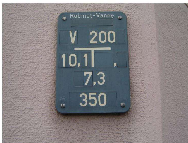
Vanne de sectionnement 200mm sur C.D. 350mm zone bleue
